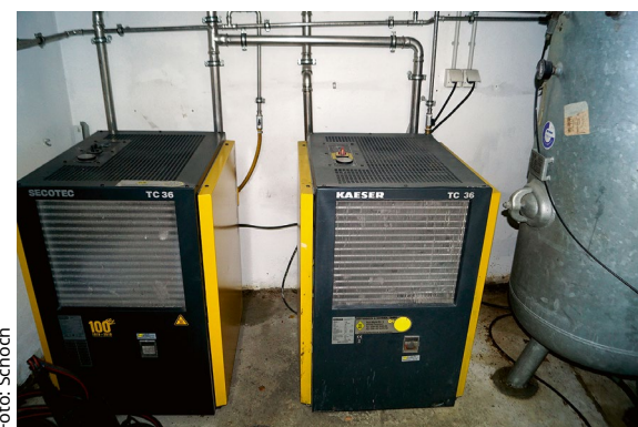
Kompressoren und Druckbehälter müssen regelmäßig gewartet werden.
