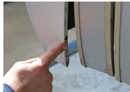
... und nimmt akribisch alle festgestellten Schäden auf.
