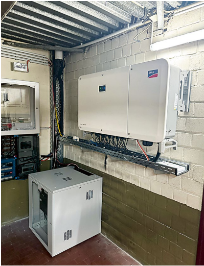
Ein Lastmanagement sorgt dafür, dass nie mehr als 80 Kilowatt ausgereizt werden.
