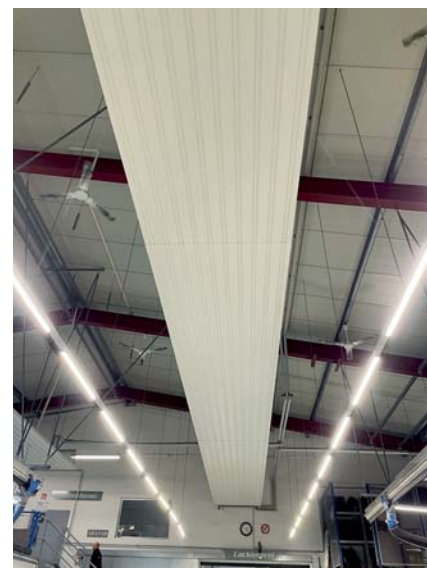
Deckenstrahlplatten sind im gesamten Betrieb für die Heizung zuständig.
