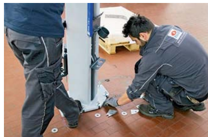
Schritt 5: Der Ausgleich von kleinen Unebenheiten erfolgt mittels Unterlegblechen, die Prüfung mittels Wasserwaage.
