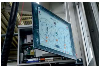
... dort werden sie bis zum Schaltschrank geführt und angeschlossen.
