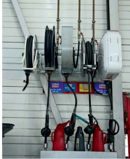
Das Ölabfüllsystem erlaubt das saubere Arbeiten mit Motorenölen direkt in der Halle.
