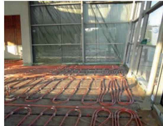
Die neue Ausstellungshalle wird mit einer Fußbodenheizung beheizt
