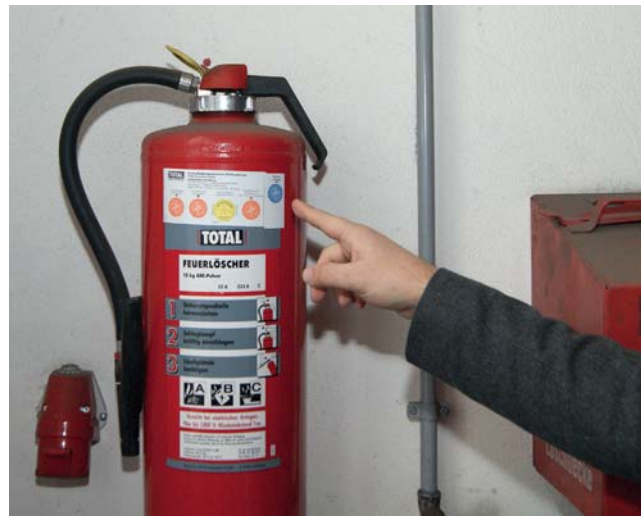
Wird gerne übersehen. Der Prüf- beziehungsweise Instandhaltungsnachweis der Feuerlöscher.
